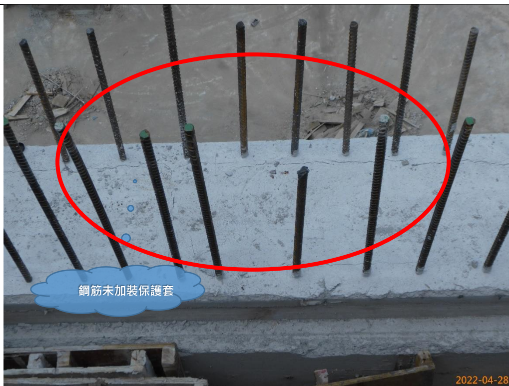
鋼筋未加裝保護套
