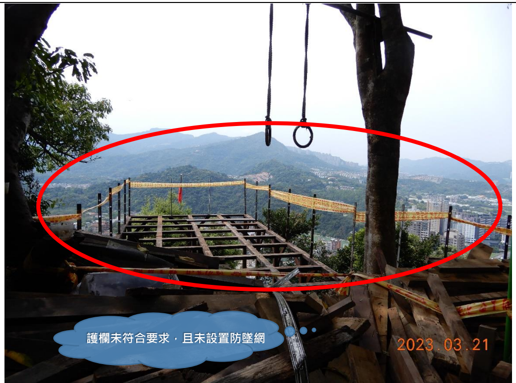
護欄未符合要求，且未設置防墜網
