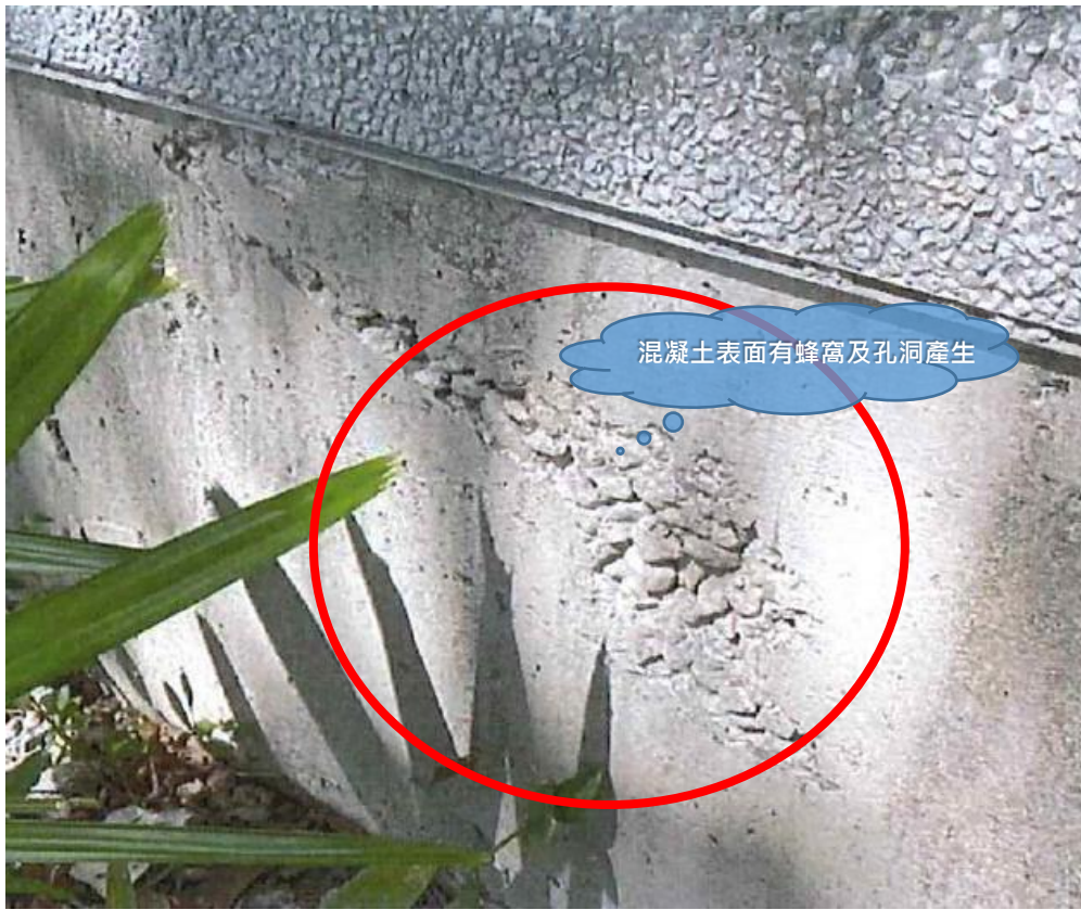
混凝土表面有蜂窩及孔洞
