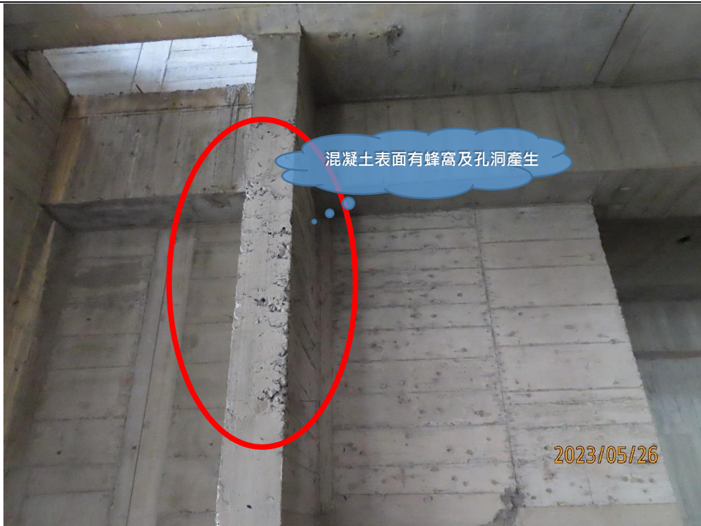
混凝土表面有蜂窩及孔洞
