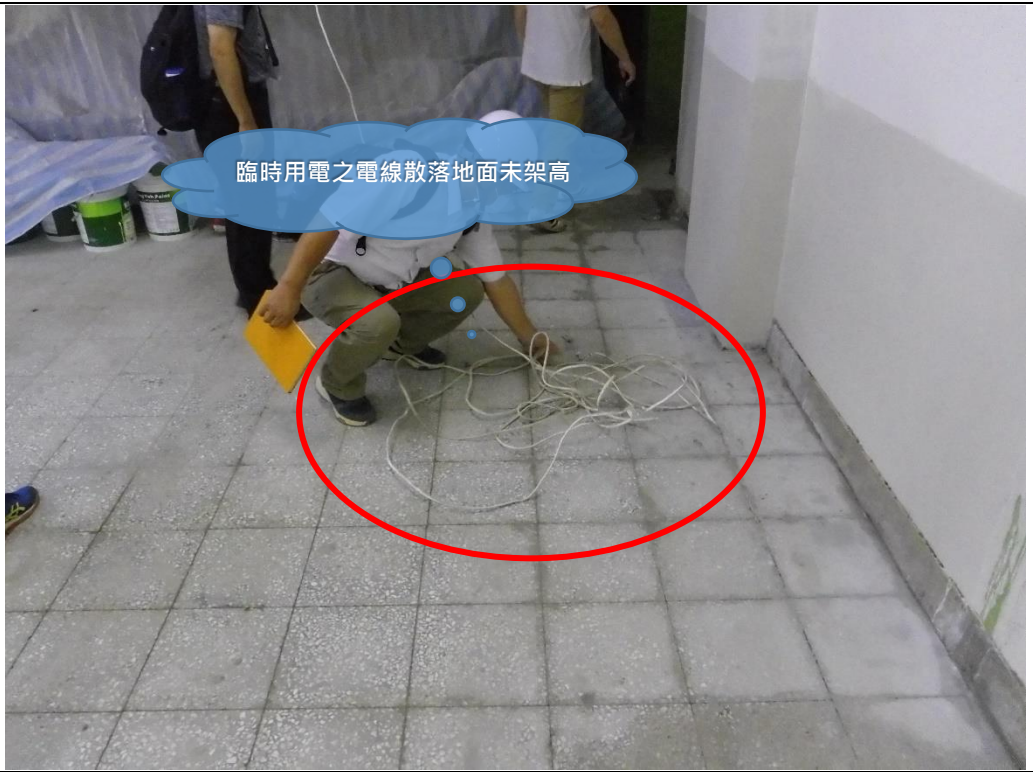
臨時用電之電線散落地面未架高
